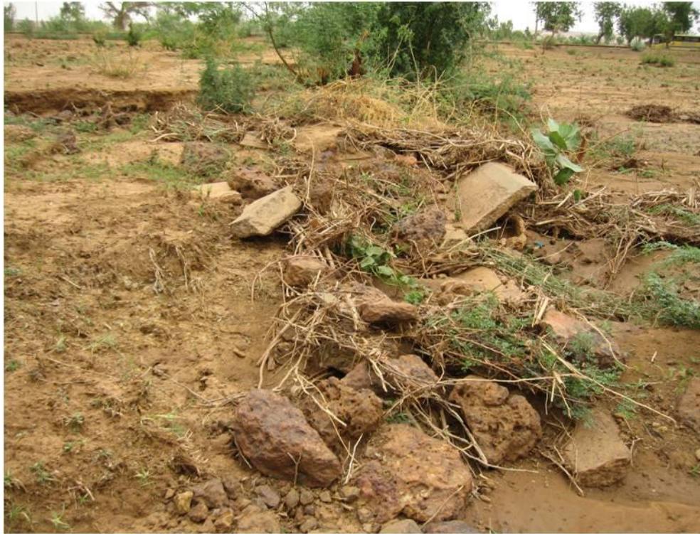
Photo 3: Canal secondaire S4 endommagé
