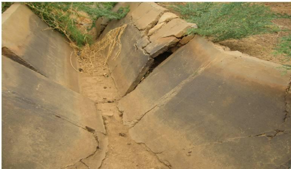
Photo 4: Détérioration du revêtement des canaux
